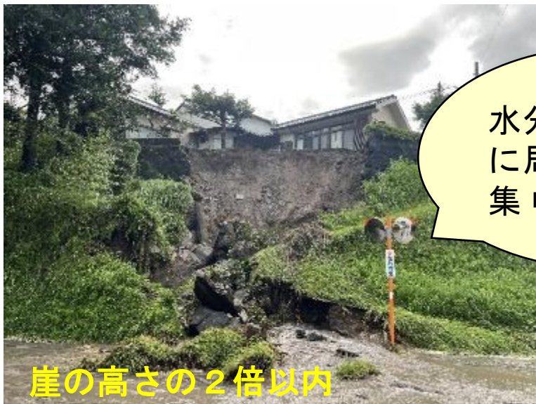
のり面崩壊の状況（16：40頃発生）
