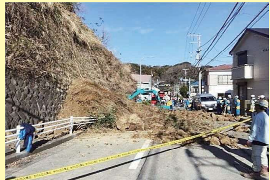
崩壊土砂状況（側方より）
