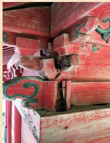
屋根の荷重で裂けた組物
