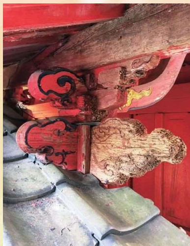
雨漏りで腐食した装飾部
