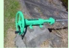
ゲート、バルブの更新
