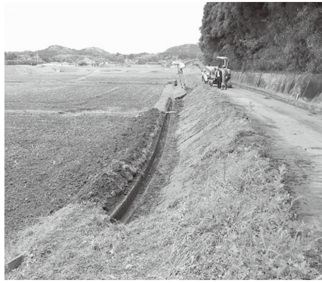
行場を失った水流が路面を洗い崩壊した法面の復旧状況
