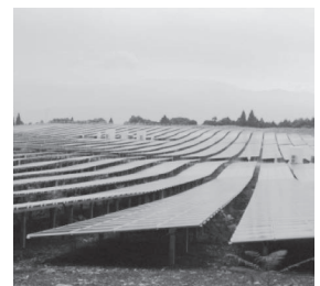
メガソーラーパネル設置状況
