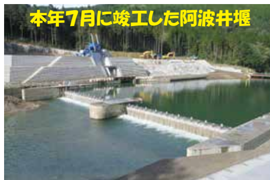
▲2基の制水ゲート（23 m×2基）と取水口（農業・発電用）、魚道などを整備。
