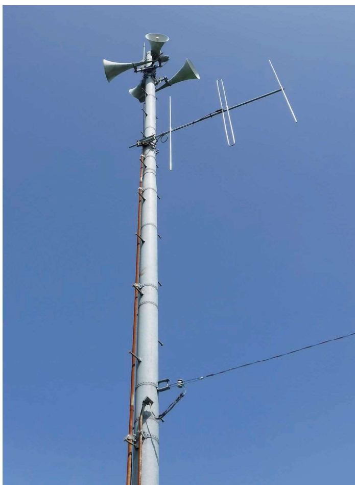
屋外スピーカーの設置場所
