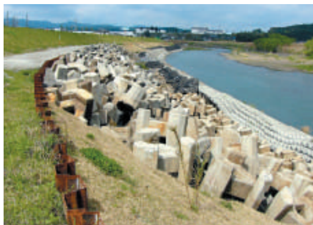
船渡橋下流左岸護岸洗堀状況(未施工)
