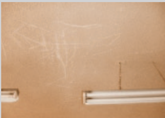
天井に吹付けされたアスベスト
