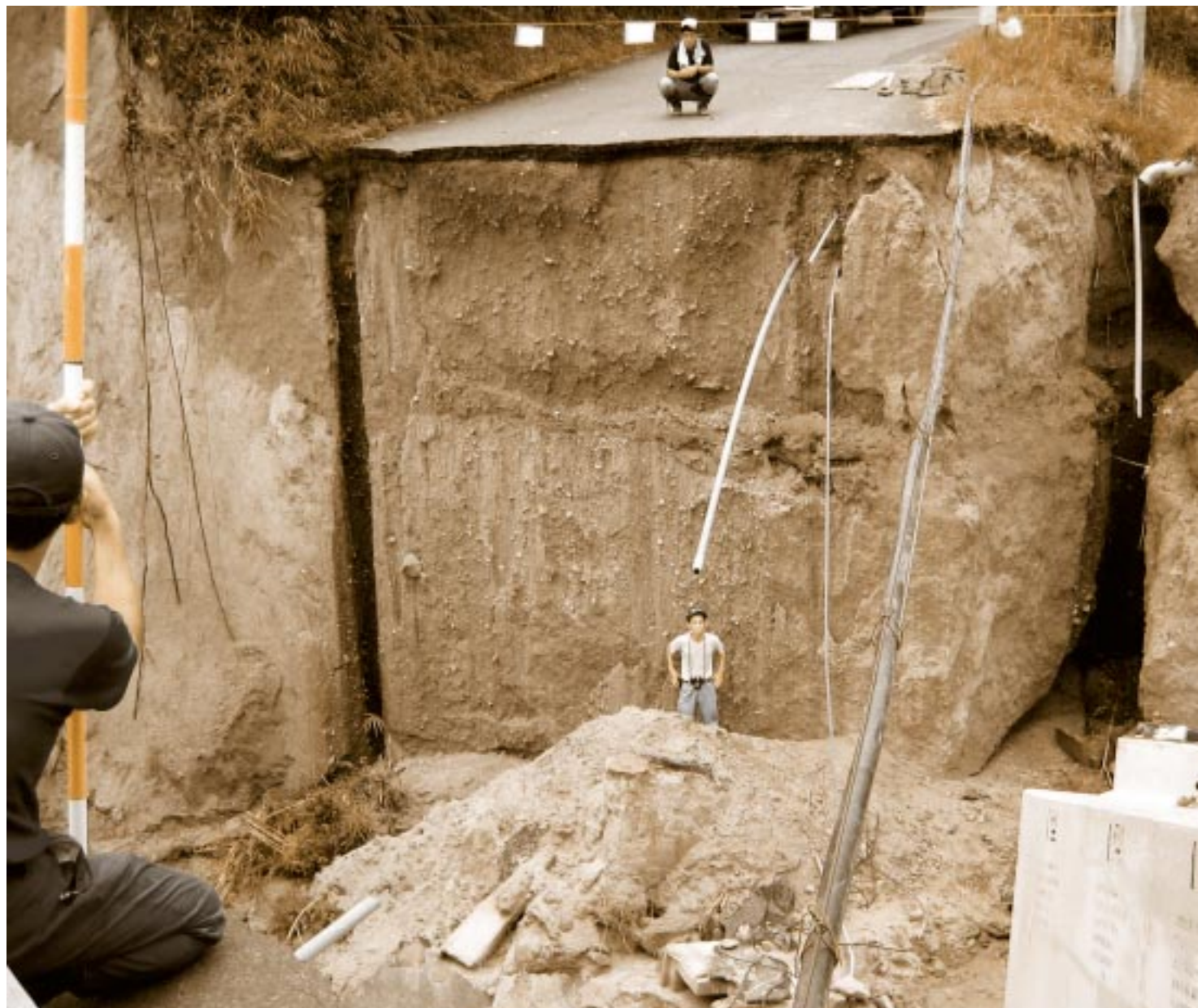
町道、農地が崩落・轟地区 かしたなし (頭無)
