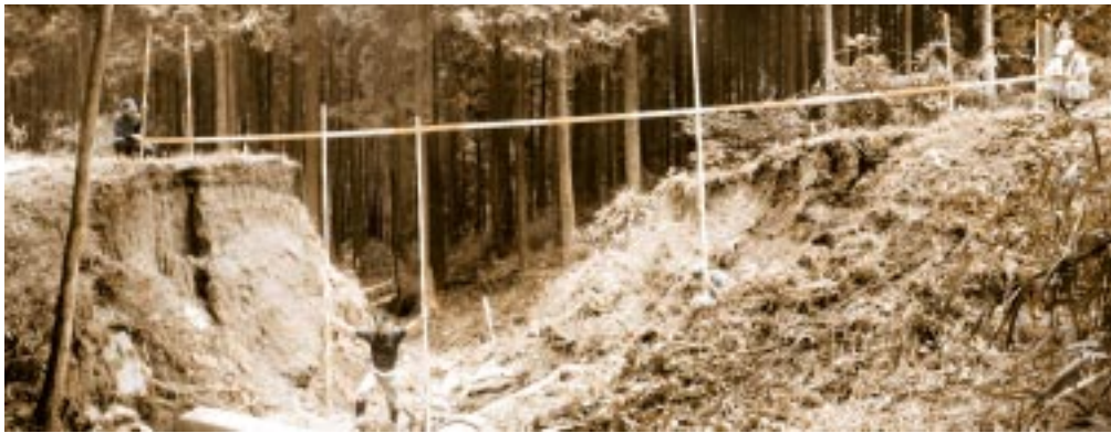
崩壊した林道枯木ケ尾線(延長12m)
