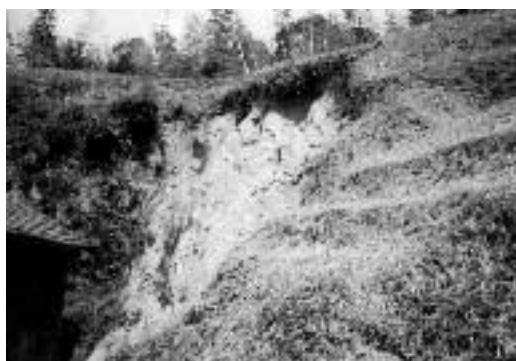
宅地内の法面が崩壊（米永地区）
