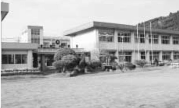
老朽化した吉松小学校校舎
