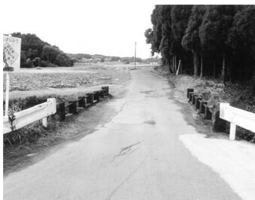
改良が望まれる北方本線湯穴橋
